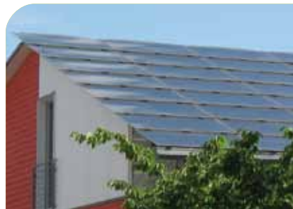
Un exemple de bâtiment équipé en panneaux photovoltaïques à Fribourg.
