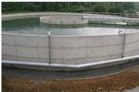
Les boues des stations d'épuration (ici la nouvelle STEP de Lillebonne) peuvent être transformées en matériaux pour la construction HQE.
